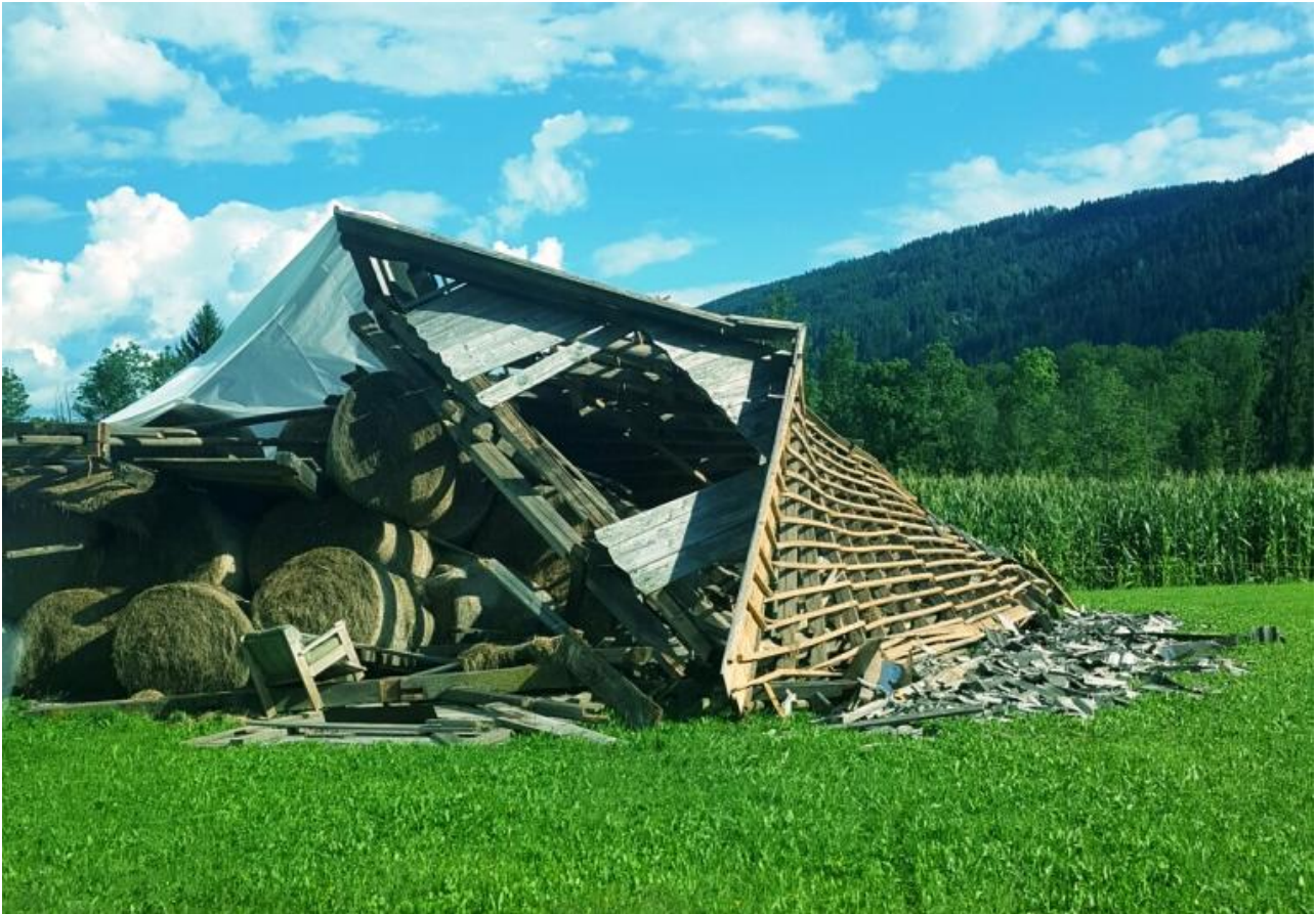
Abbildung 41: Sturmschaden in St. Lorenzen im Gitschtal, 2017
