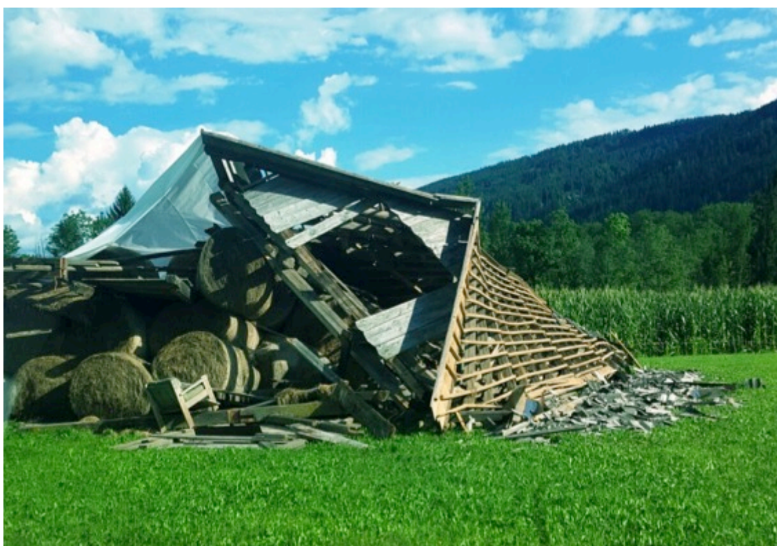
Abbildung 41: Sturmschaden in St. Lorenzen im Gitschtal, 10.08.2017
